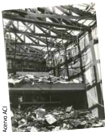
O prédio quase destruído, após os incêndios de 1984
